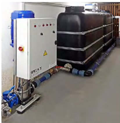
Pufferspeicher und Druckerhöhungsanlage
