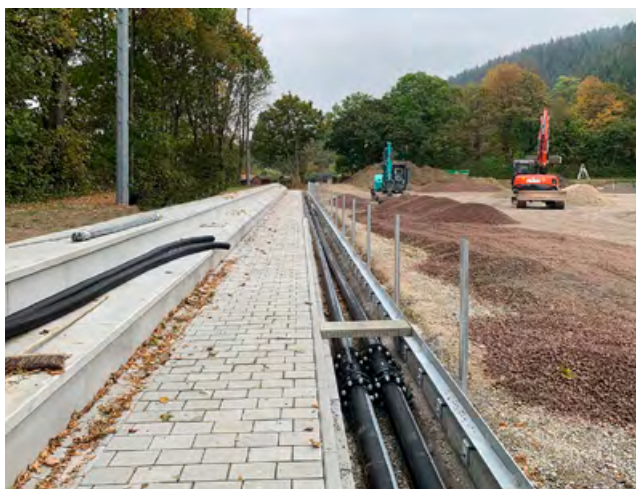
Sitzstufenanlage, davor der Tichelmann-Verteiler
