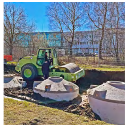
Dreiteilige Zisterne im Batterieverbund
