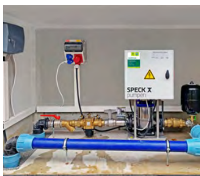
Moderne Beregnungstechnik sorgt für die ...
