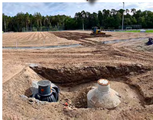
40 m 3 fassende Zisterne mit Pumpenanlage zur Erhöhung des Wasserdrucks
