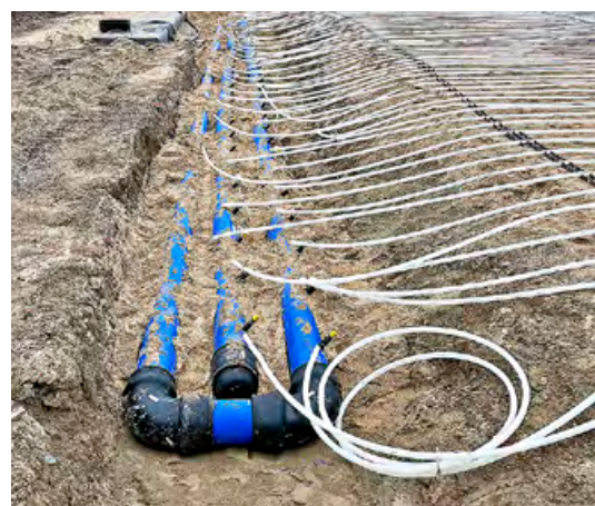
Rasenheizung mit Tichelmann-Verteiler
