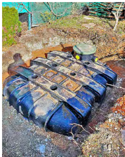
Flachzisterne als Pufferspeicher
