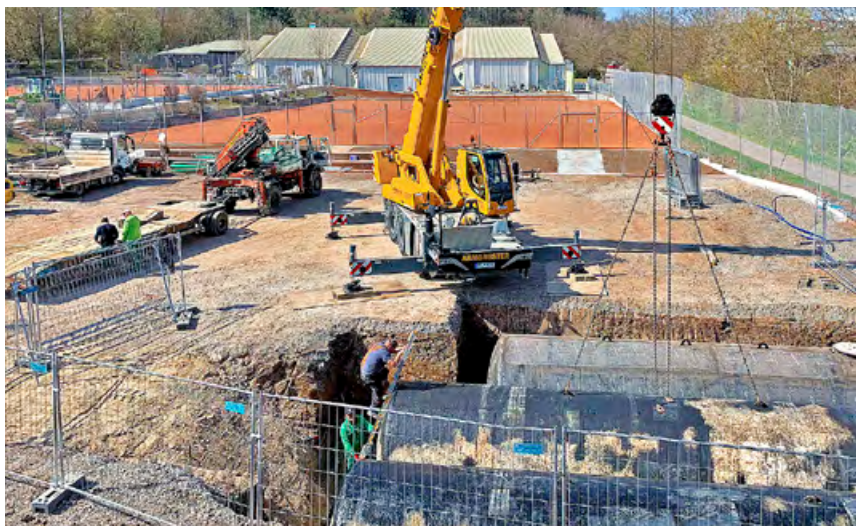
Die Dächer der Dreifach-Halle entwässern in die Zisterne
